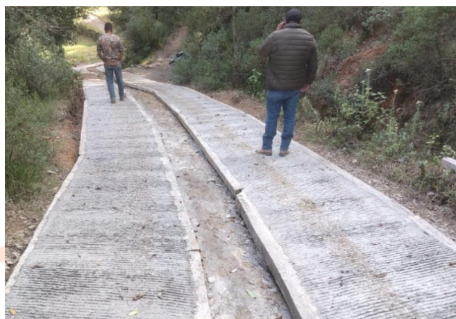
Rodadas de Concreto en camino parte baja Tepozanes, Comunidad Carboneras.
